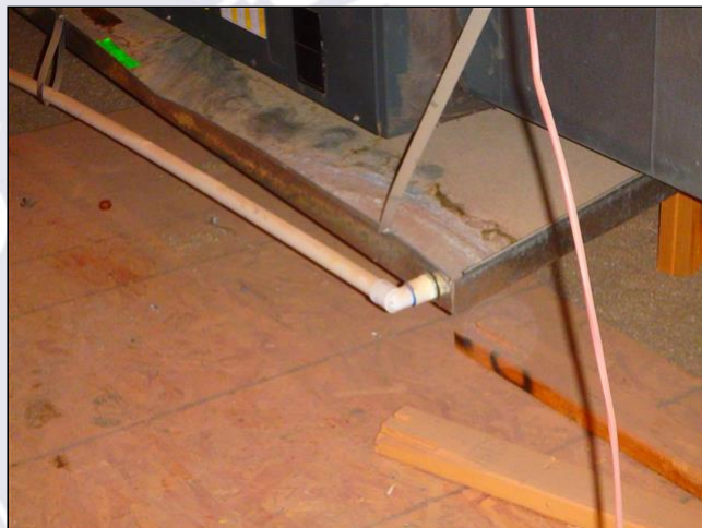
Pan no rust
